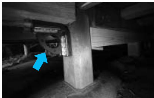
床下の耐震補強金物(耐震リング)
