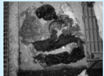
下水道管につまった下着類
