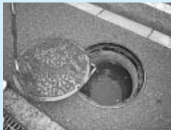
油で閉塞したマンホール
