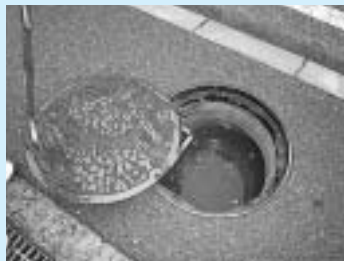
油で閉塞したマンホール
